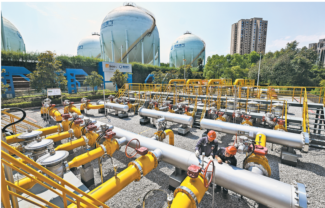
八月一日，重庆燃气集团输配分公司江北区分塘储配站，作业人员正在对管道连接处进行巡检。 首席记者 龙帆 摄影视觉重庆
