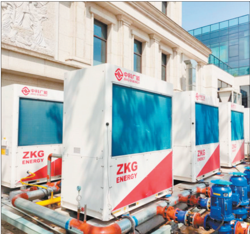
燃气热泵产业化示范工程。
