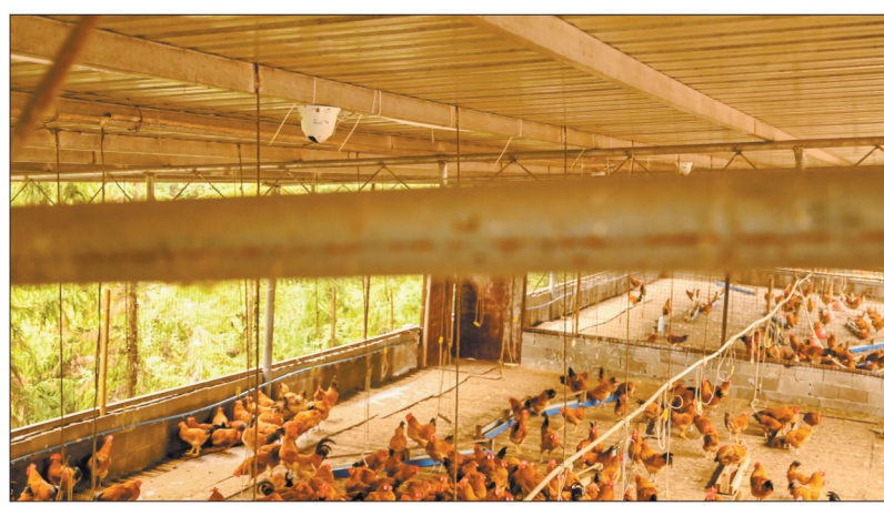
石柱智慧养鸡场内安装了智能摄像头,可以随时监控鸡的活动状况。
