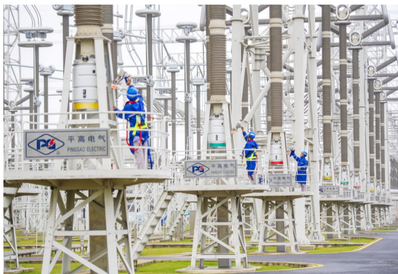
世界最高电压等级换流站完成“体检”。
