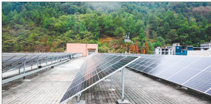
已投入使用的彭水一中光伏发电项目。
