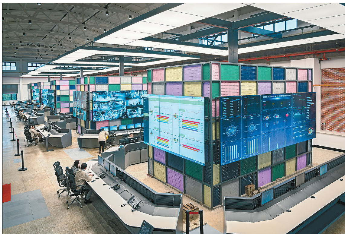
中冶赛迪建设的全球钢铁行业首座智慧集控中心——韶钢智慧中心。(受访者供图)
