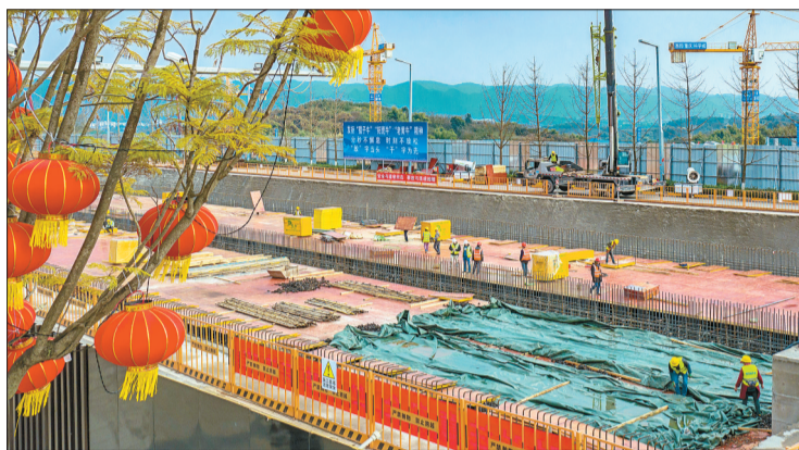
二月九日,西部(重庆)科学城高新大道项目,工人正抓紧施工。重庆日报记者 龙帆 摄
