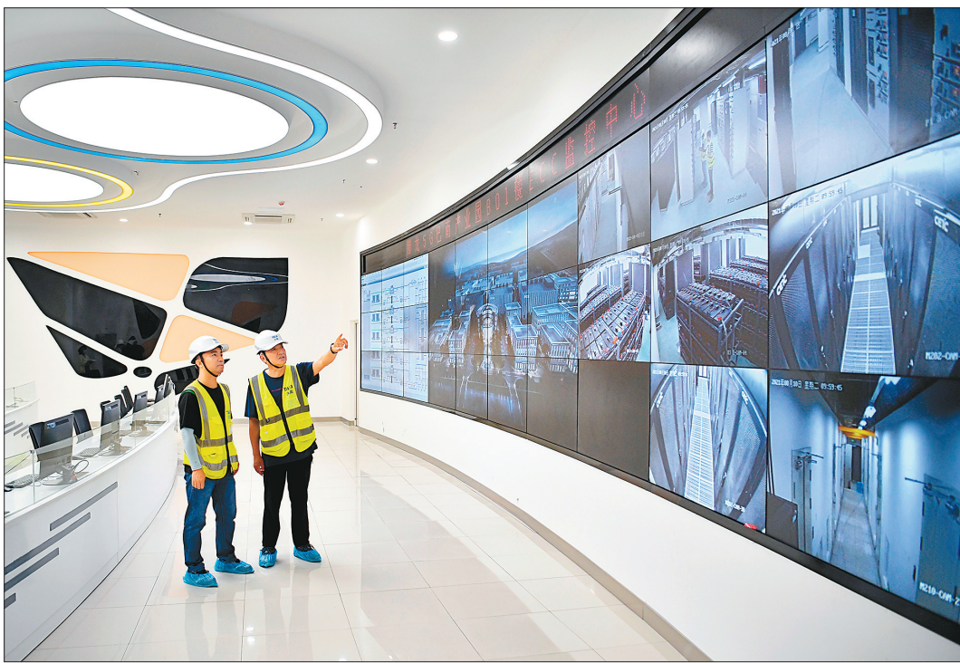
日前,巴南经济园区腾龙大数据中心,工作人员在监控中心监管设备运行。
