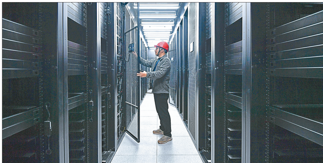
位于长寿区的重庆同城双活数据中心,工程师正在智能微模块机房进行日常维护。重庆日报记者 齐岚森 摄
