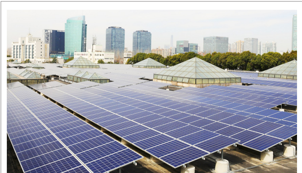
图为位于上海地铁龙阳路基地内的分布式光伏发电站(无人机照片)。
