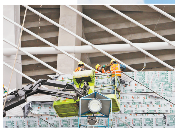
▲1月1日，龙兴足球场施工现场，工人正在高空进行金属屋面及幕墙装饰作业。（图片由中建八局提供）
