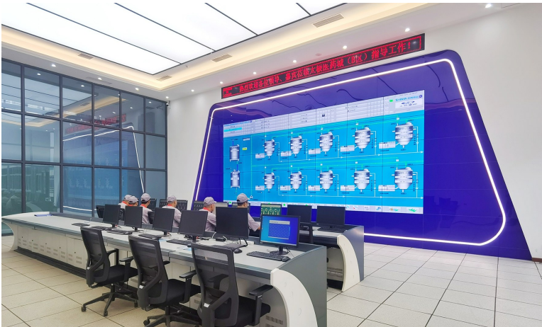
智能化中央控制室
