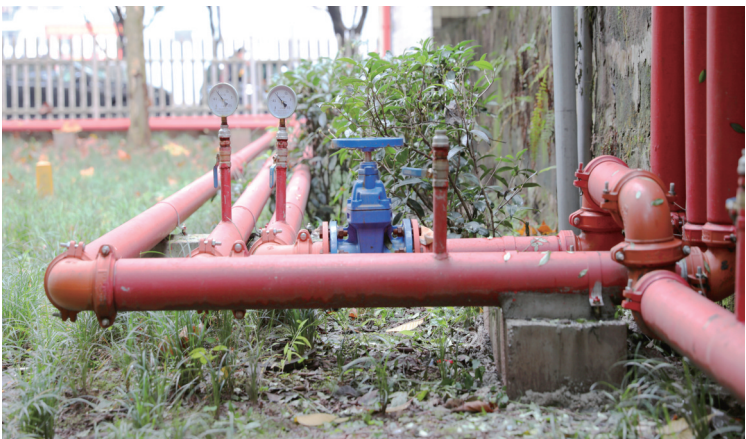
人和街道人兴路社区华夏城小区整改后的消防管网
