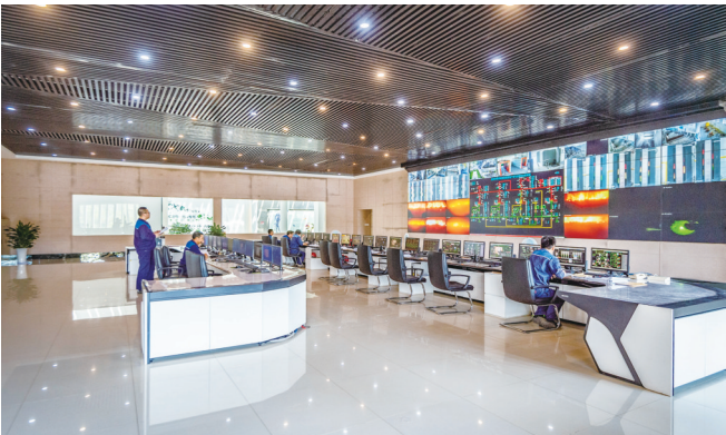
重庆水务环境集团所属三峰环境公司百果园环保发电厂,中央控制室,工程师正在查看发电厂各个环节运行情况 龙帆 摄/视觉重庆
