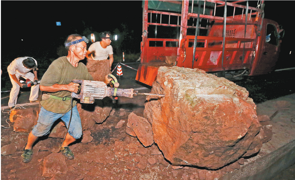
8月7日暴雨后，合安高速快速通道惠家湾路段被山坡上掉落的巨石阻断，镇村干部连夜组织人员破石清障。
