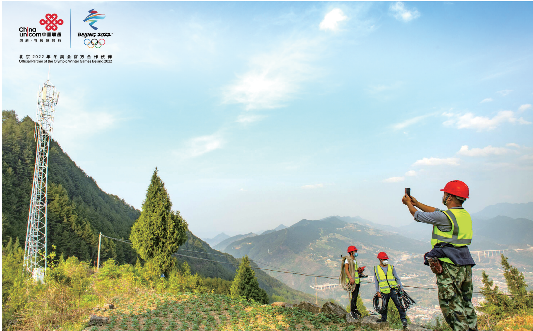
联通5G建设覆盖乡村
