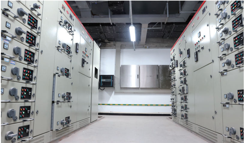
六支二项目刘家院子站环控电控室
