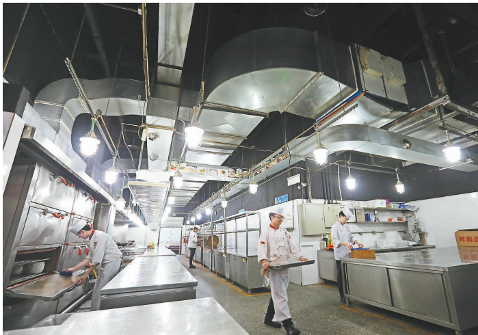
2020年10月27日,在九龙坡区石桥广场俏巴渝大酒楼后厨,安装油烟治理系统两年多,油烟排放限值低于国家现行标准50%。近年来,我市完成餐饮业和公共食堂油烟治理1.1万家,基本做到公共机构食堂和重点餐饮业油烟治理“全覆盖”。
