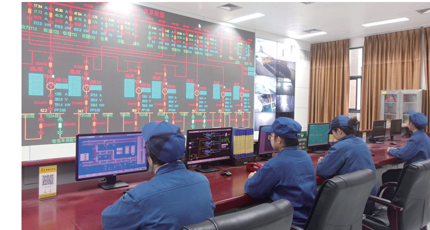
涪陵卷烟厂动力车间工作人员实时监控能源管理系统
