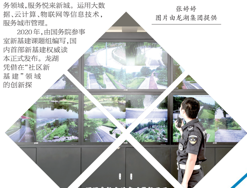
园区中控室的实时监控画面
