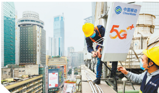
中国移动重庆公司网优人员正在对5G基站进行调试。
