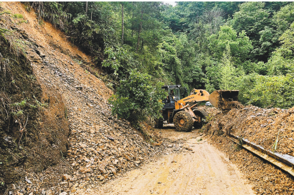
推土机在清理诸佛乡阻断交通的塌方体。通讯员 任俊 摄/视觉重庆
