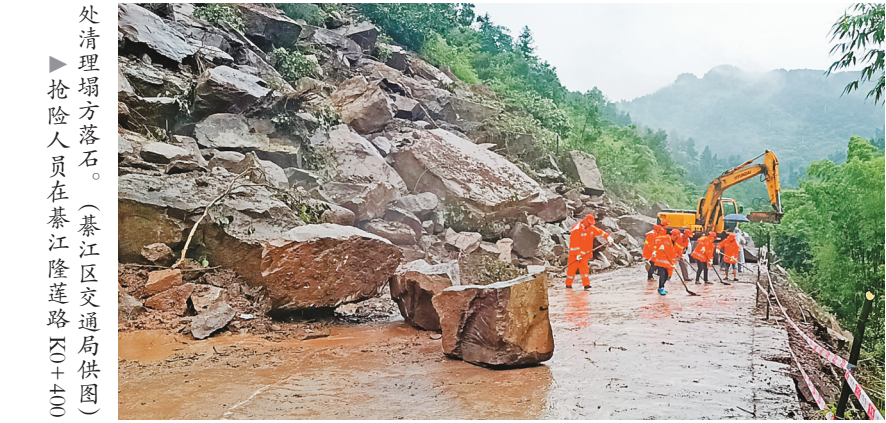
处清理塌方落石。(秦江区交通局供图)
