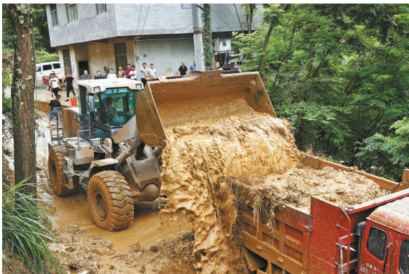
6月13日，黔江区金洞乡杨家社区山体滑坡，装载机在清理堵塞公路的泥石流。 特约摄影 杨敏/视觉重庆
