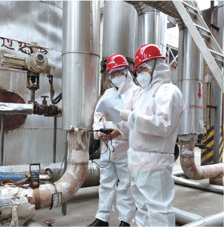
重庆市特检院检验人员在攀钢集团重庆钛业有限公司检验硫酸装置压力容器
