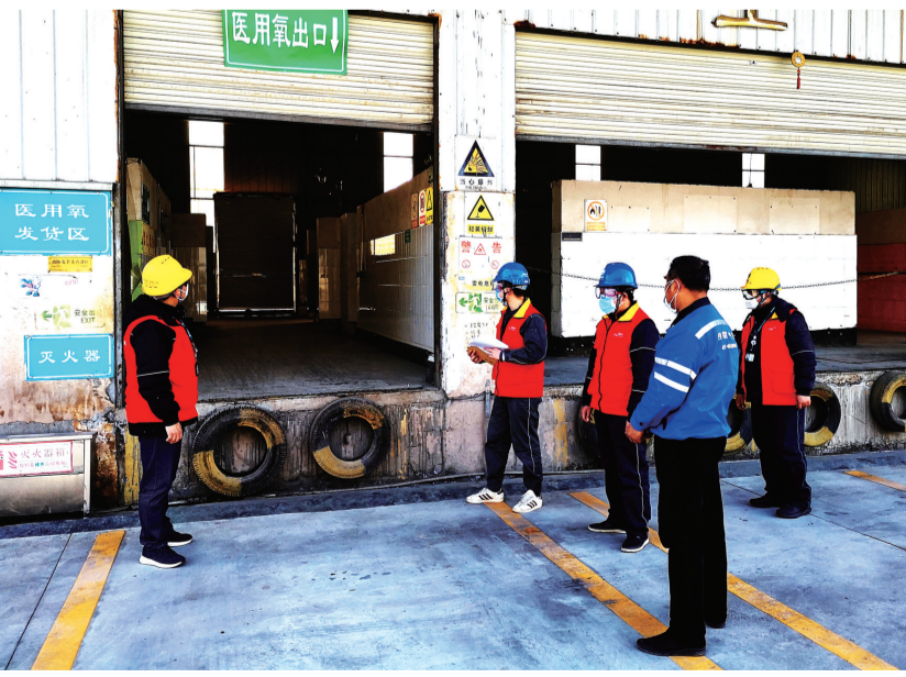
永川供电公司红岩共产党员服务队巡视四方井开闭所,保障良俊气体有限公司医疗用氧生产用电。
