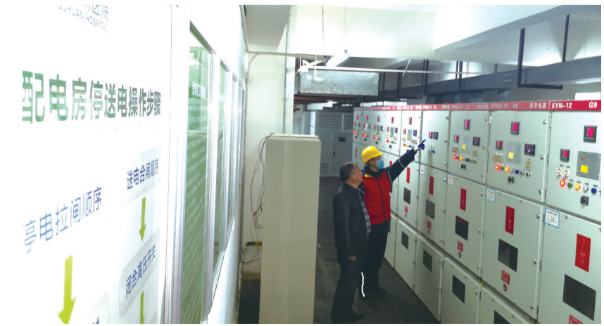
永川供电公司红岩共产党员服务队在渝西片区确诊病例集中救治定点医院——重医附属永川医院巡视配电房。
