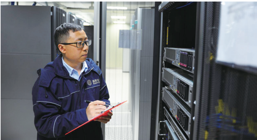
韩世海在机房对信息网络设备进行安全巡检 功化解危机实现了“零失误、零事故”的承诺。当他看到冬奥会开幕式上璀璨的灯光照亮鸟巢时，那份自豪与安心，是对他所有付出最好的回报。
