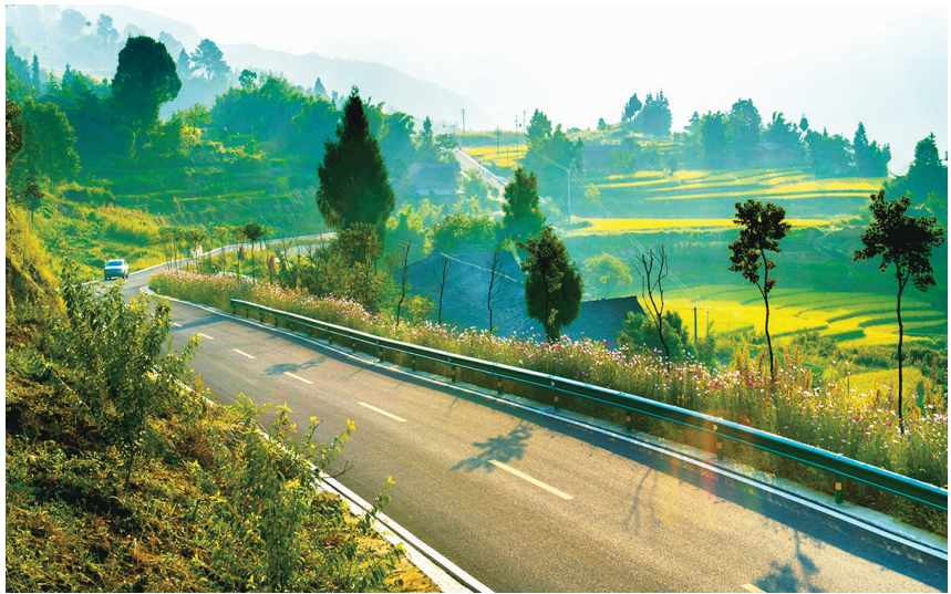
梁平区蟠龙唐家坡农村公路波形护栏
