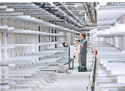
巴南区地下综合管廊，工作人员正在检查网络交换机运行情况。(本报资料图片)
