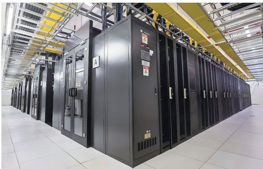
数据中心机房
