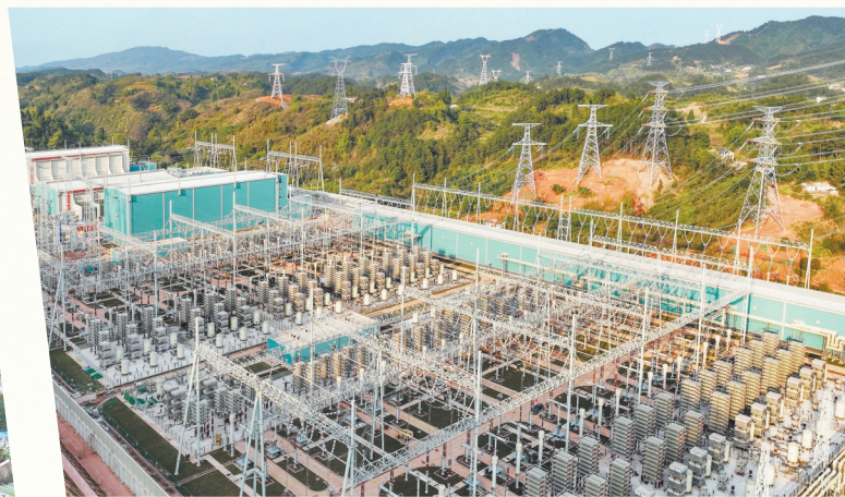
▲位于渝北区大湾镇的渝北换流站。(摄于2025年4月2日) 记者 张锦辉 摄/视觉重庆
