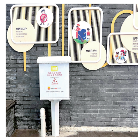
南纪门中兴大厦安装的化粪池监测设备
