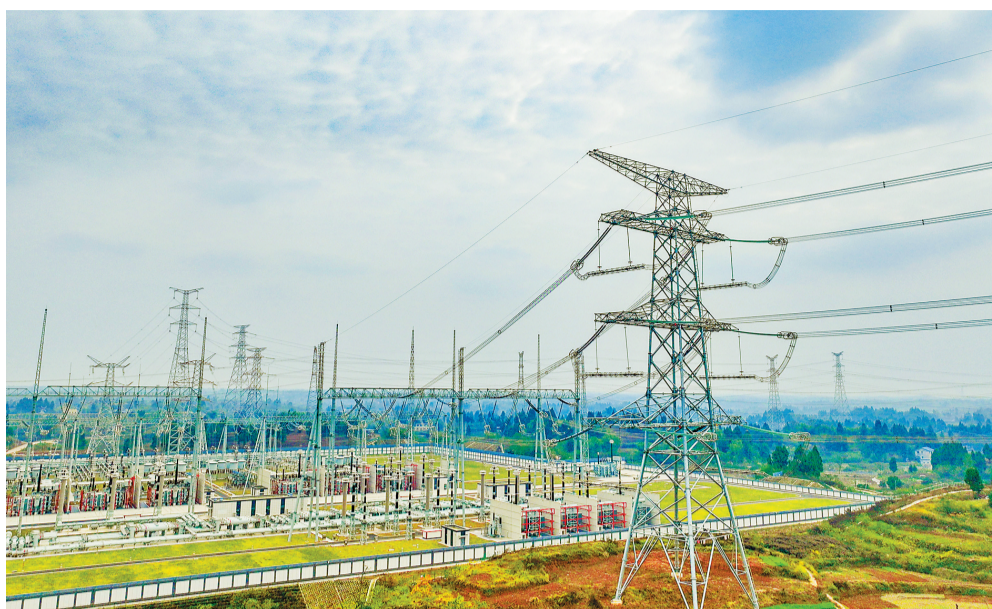
12月27日,位于铜梁区少云镇的1000千伏变电站建成投运。
