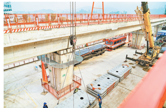
12月15日，轨道交通27号线首块预制轨道板在璧山站至虎溪站段顺利起吊，标志着全线进入铺轨阶段。
