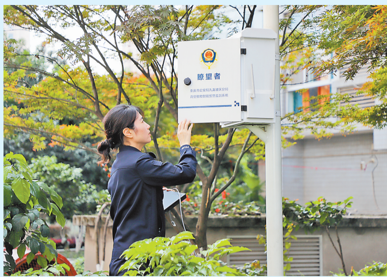
民警在九龙坡居民小区调试“瞭望者”高空抛物智能预警监控系统。(受访单位供图)
