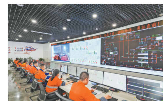
10月14日，位于万州区的重庆市九龙万博新材料科技有限公司，工作人员在控制设备运行。
