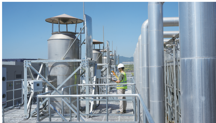
京东方B12综合能源站工作人员对设备运行温度进行检测记录
