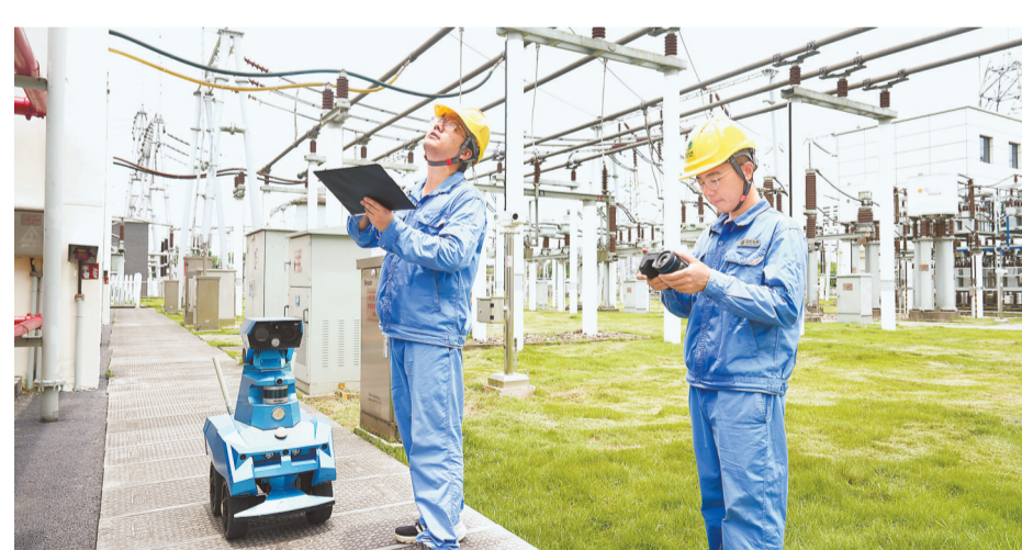
8月20日，重庆500千伏陈家桥变电站，运维人员通过机器人和无人机等设备，开展迎峰度夏特巡工作。（国网重庆超高压公司供图）
