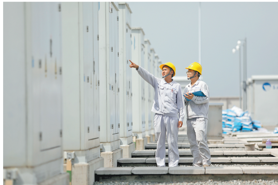
7月31日,两江龙盛储能电站内,周成利(左)和同事在烈日下巡查设备。 记者 罗斌 摄/视觉重庆
