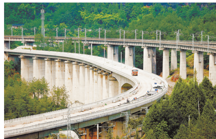
6月29日，渝湘高铁重庆至黔江段玉泉村特大桥加紧施工。 特约摄影 杨敏/视觉重庆
