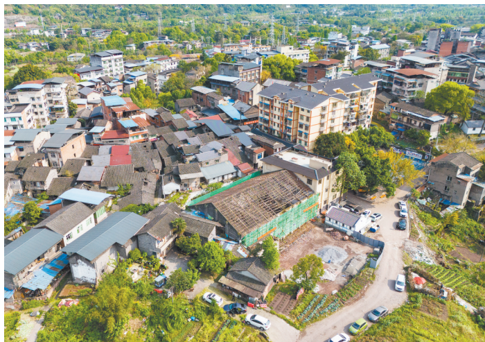
近期,北碚区城市更新项目开工。图为静观老街老电影院在翻新(本报资料图) 记者 李雨恒 摄(视觉重庆)
