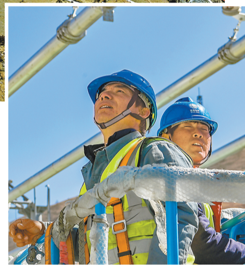
三月二十九日，四川省甘孜藏族自治州康定市呷巴乡甘孜1000千伏特高压变电站项目。
