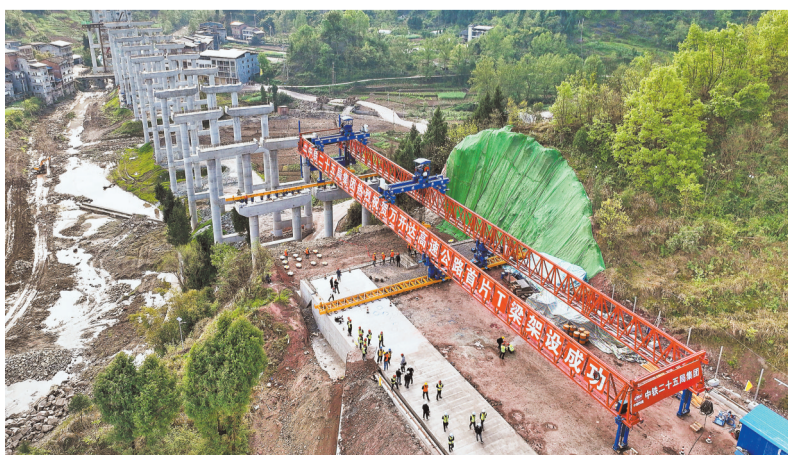
三月二十八日，万开达高速公路寨子坡大桥施工现场，全线首片T梁完成架设。 记者 罗斌 摄/视觉重庆
