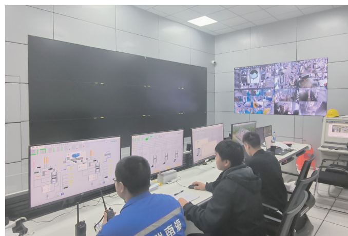
科瑞南海控制室
