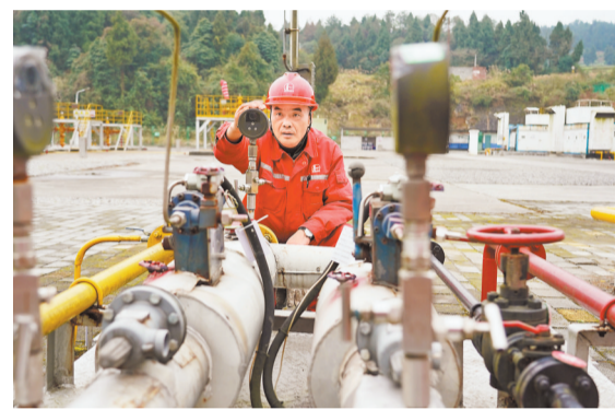
2月11日，杜永国正在进行巡检。 通讯员 毛红兵 张宁 摄/视觉重庆
