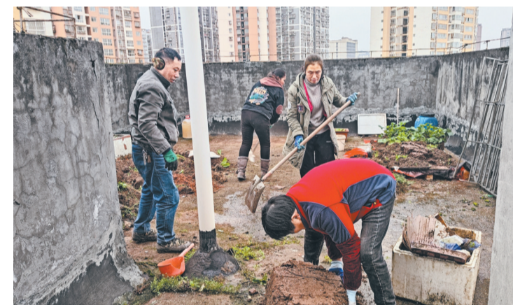
渝北纳帕溪谷小区，楼顶违规栽种的蔬菜已及时清除。（受访者供图）
