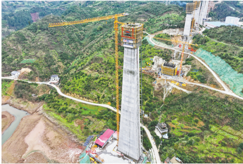
封顶的渝万高铁蔡家沟双线特大桥最高墩。（受访单位供图）
