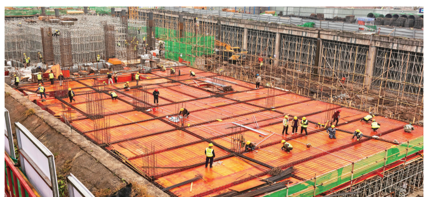
江北嘴金融中心项目已完成排水管网迁改、边坡支护以及基础工程，正在进行主体结构和钢结构施工
