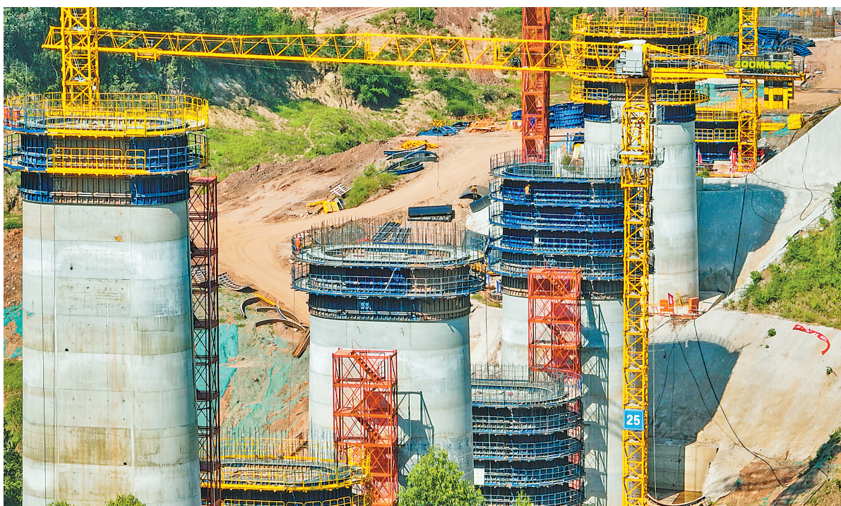
二〇二三年九月七日，成渝中线高铁千枚墩双桥特大桥施工现场，施工人员正在加紧作业（素材图片）。 首席记者 龙帆 摄 视觉重庆
