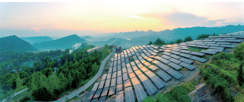
人和光伏发电站
